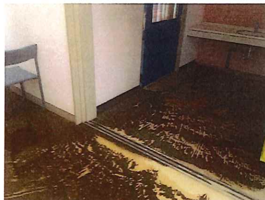
男性トイレ入口
